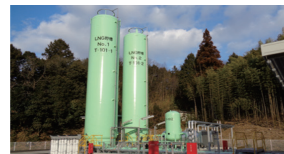
勝央中核工業団地内に設置されたLNG基地
