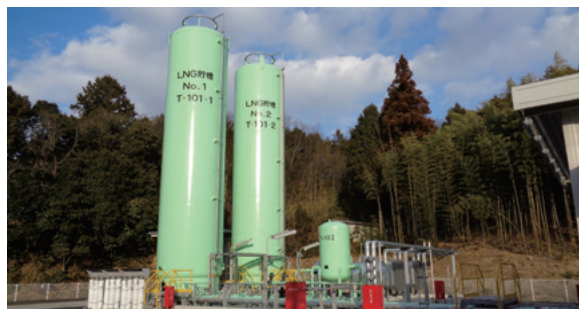
勝央中核工業団地内に設置されたLNG基地
