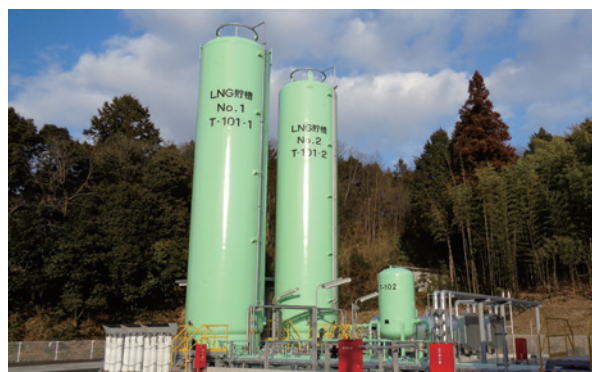
勝中央核工業団地内に設置されたLNG基地
